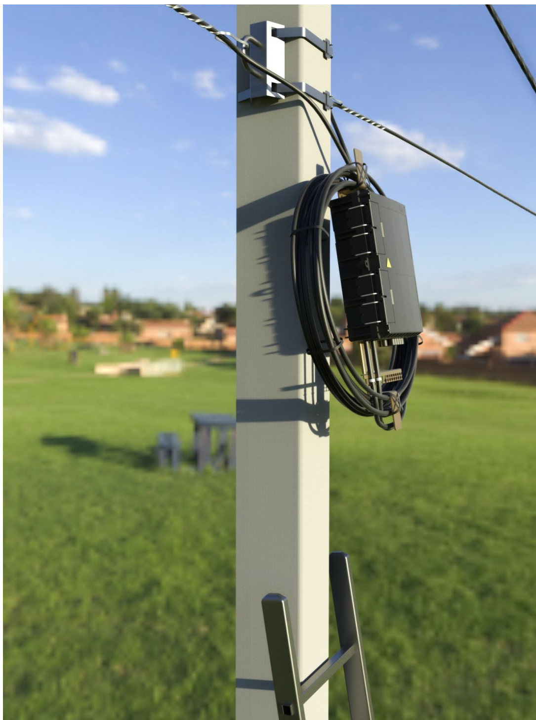
Рисунок 3. Скрепить кабели, смотанные в плотное кольцо, всепогодной липкой лентой и УФ-стойкими пластиковыми хомутами по меньшей мере в 4х местах вне кронштейна и прикрепить кабели к кронштейну X-образно установленными УФ-стойкими пластиковыми хомутами.
