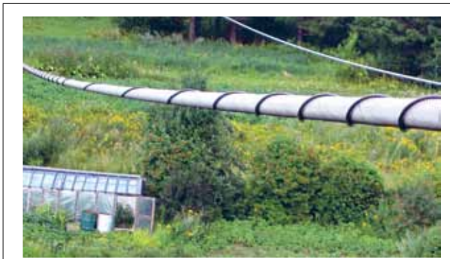
Рис.12. Оптический кабель, спирально навитый на фазный провод ЛЭП 110 кВ
